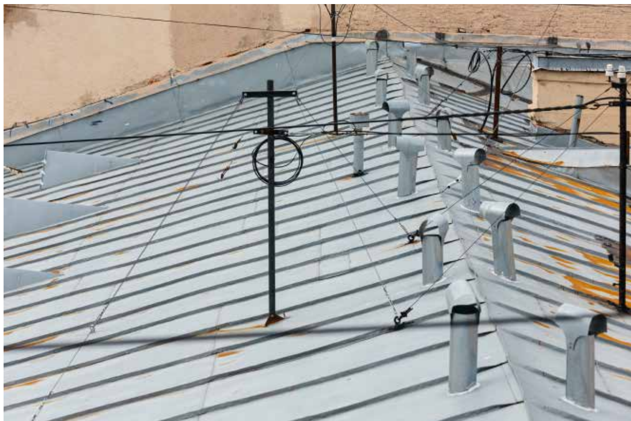
L'aggressività chimica delle sostanze emesse dalle canne fumarie può intaccare il manto metallico
