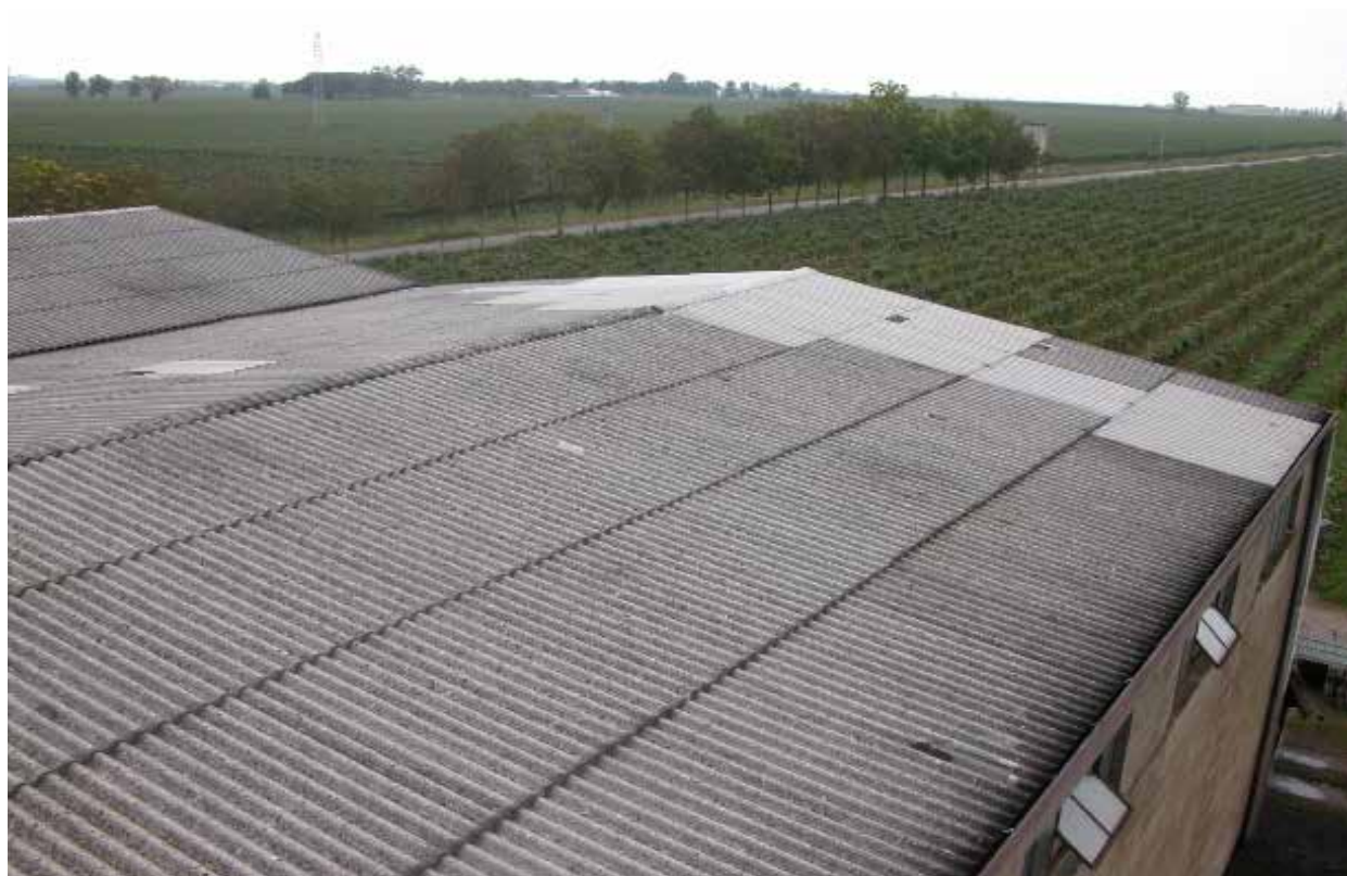
Le coperture ondulate in fibrocemento sono ampiamente diffuse sul territorio
